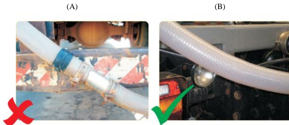
Figura 1. Mangueira inconforme ao lado esquerdo (A) e conforme na imagem direita (B)
