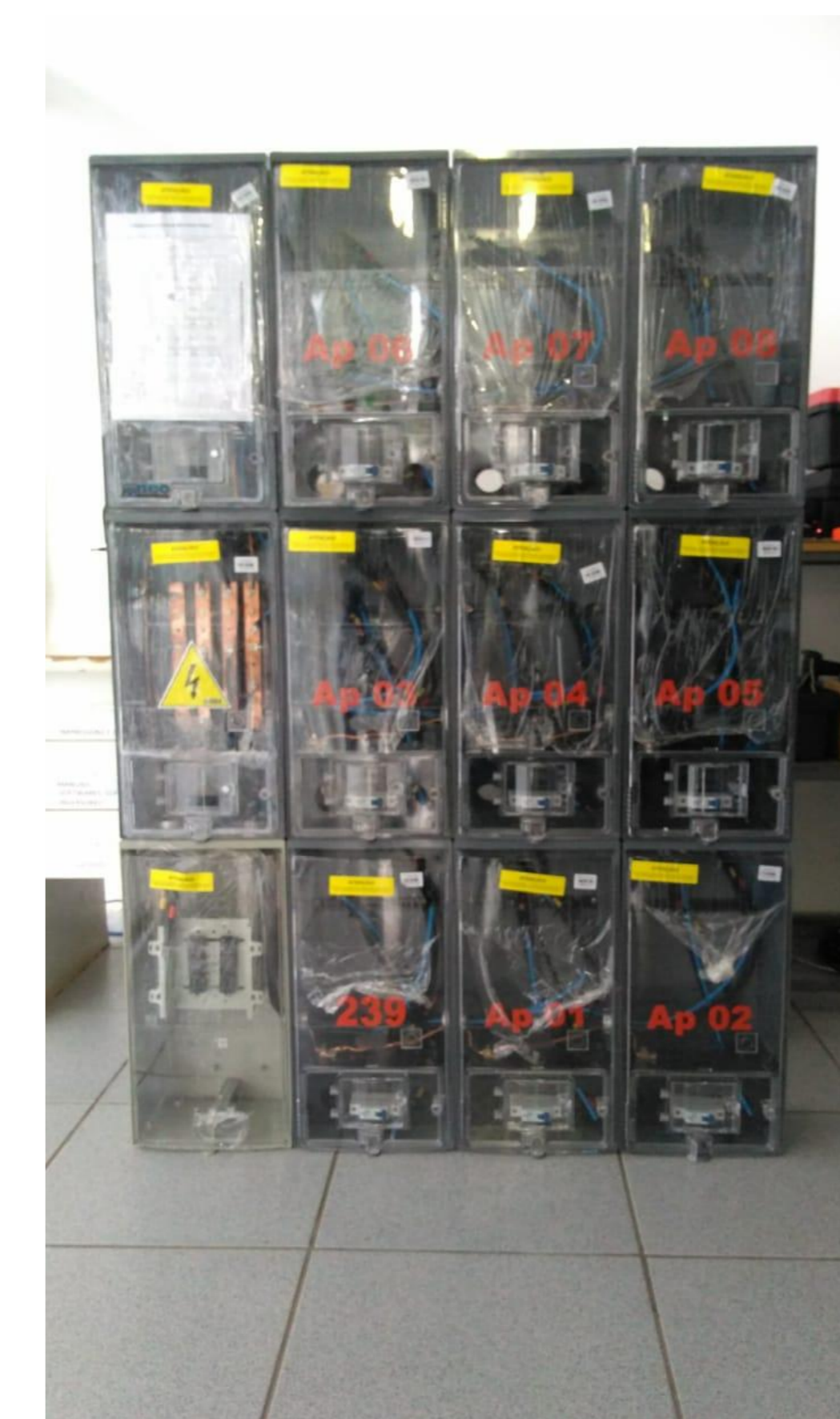
Figura: Painel para controle e medição de energia elétrica.
